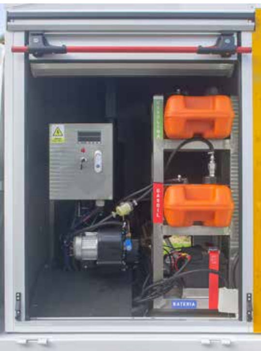
Zona insonorizada caldeira de água quente ((Opcional)
